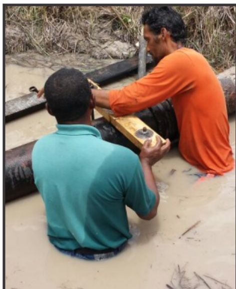
▲ Trabalhadores do SAAE, fazem o reparo de vazamento mesmo sem as mínimas condições
